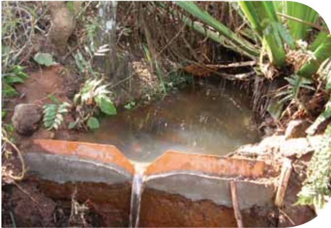
Vertedouro improvisado, para medição de vazão, sobre uma pequena barragem para captação de água, em uma das propriedades estudadas, cuja instalação e escolha do local mais apropriado se deu com a participação dos proprietários.
